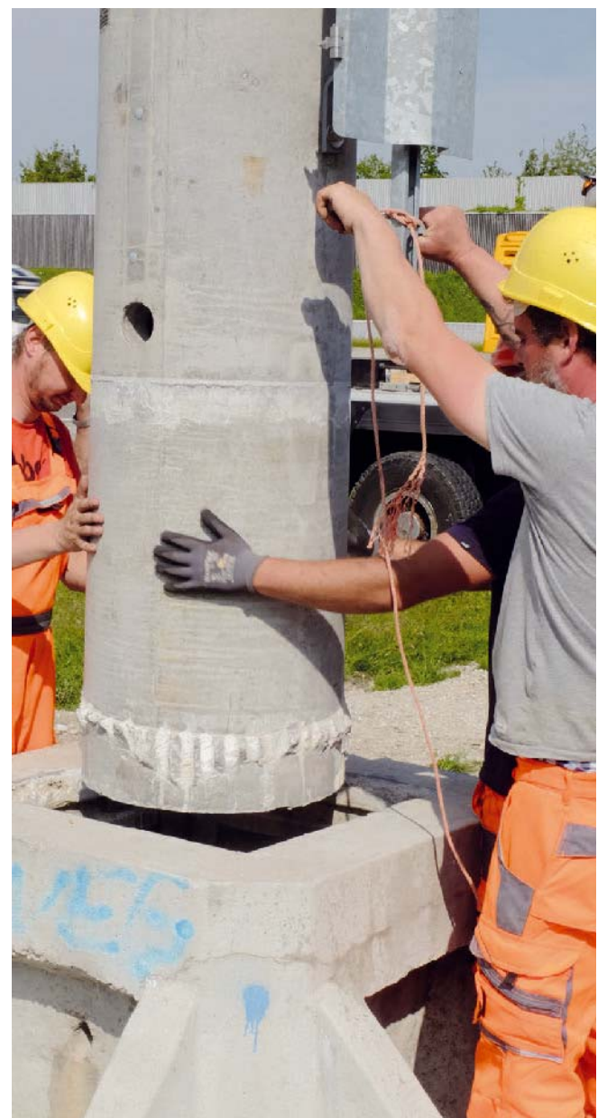
Selten muss neue Infrastruktur , wie hier ein Mast, aufgebaut werden. Straßenschilder und Mautbrücken reichen aus, um Sensorik zu montieren. Rund 1 Mrd. € bis 2 Mrd. € wird nach Ansicht von Forschern der TU München die Ausstattung für das gesamte deutsche Autobahnnetz kosten. Foto: TU München
